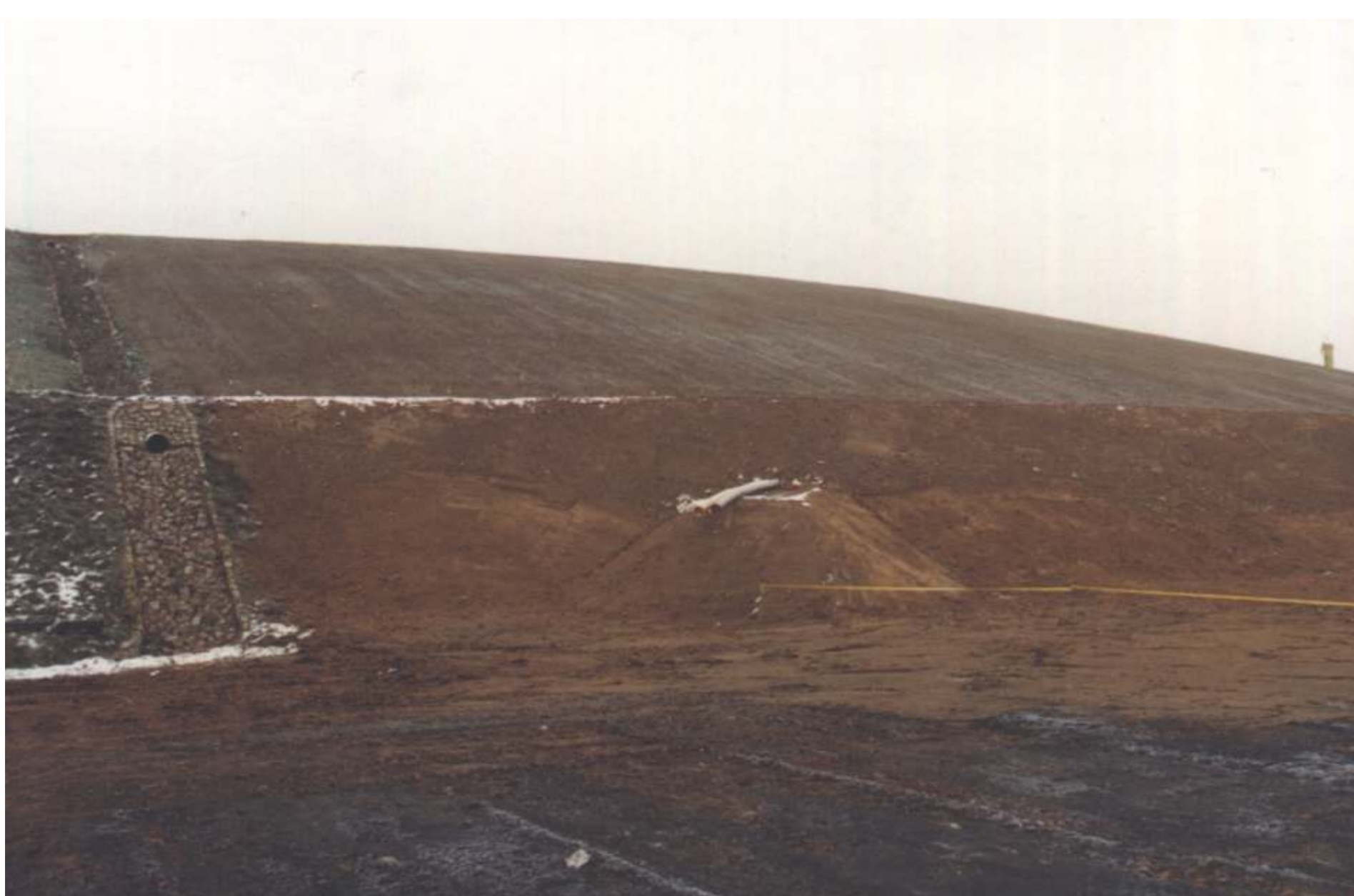
Südböschung - rechts: Gasleitungen zum Anschluss an Gasverdichterstation; links: Entwässerungsgraben zum Ableiten des unbelasteten Oberflächenwassers
