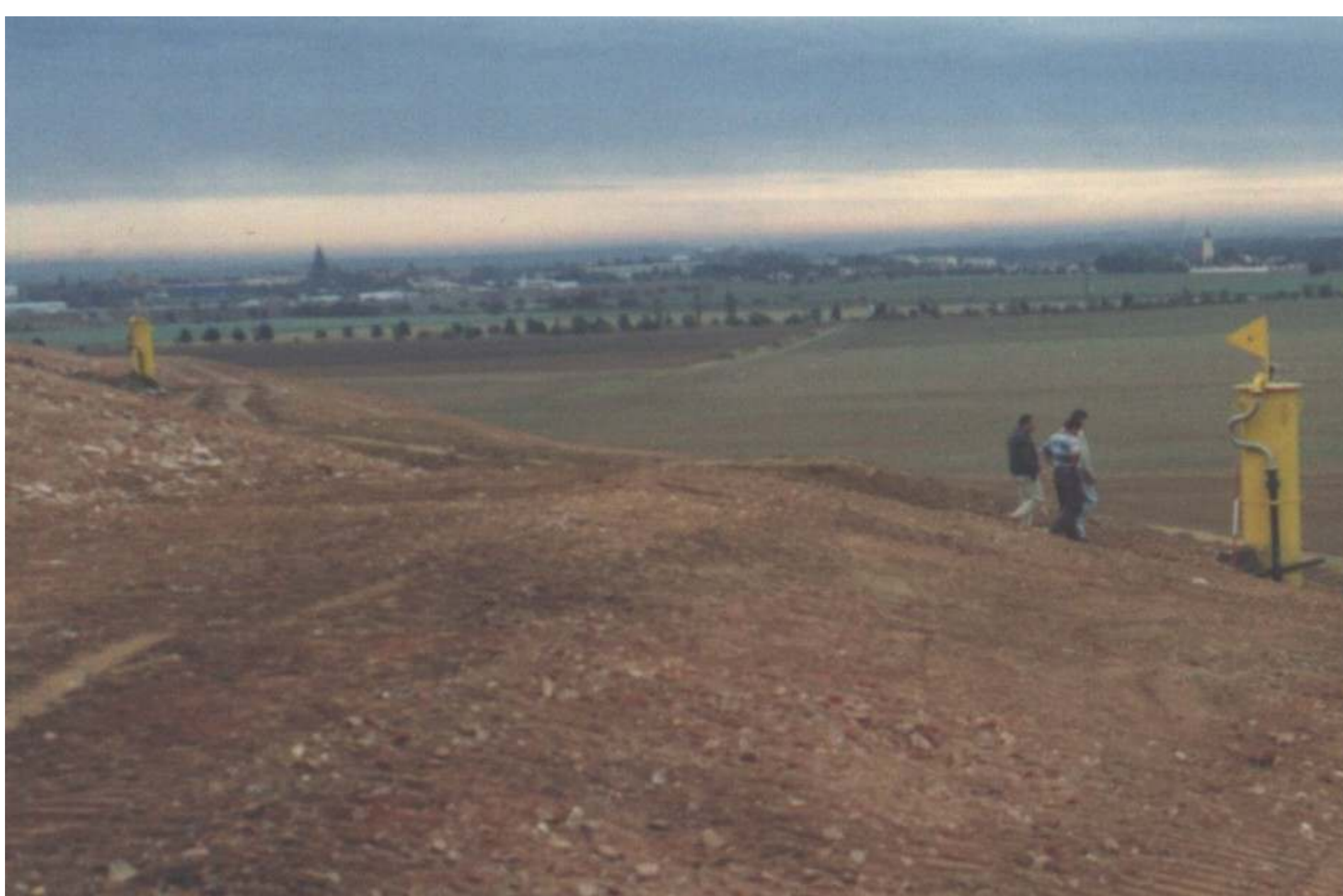
Auftragen einer Ausgleichs- und Tragschicht, 0,5 Meter stark, bestehend aus Bauschutt; Anschluss von Gasbrunnen an das Gasleitungssystem
